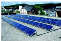
Das EnergieZentrum Balzer+Nassauer
